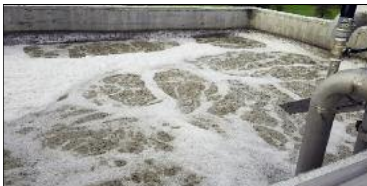
Vasca di ossidazione biologica MBBR
