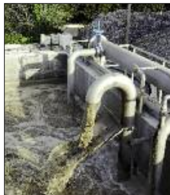
Sistema air-lift in funzione
